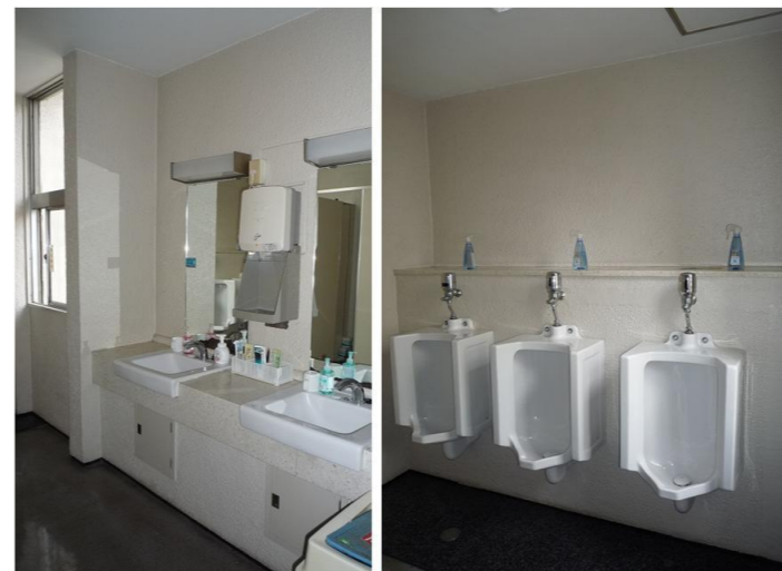
改修前のトイレは、白の塗装壁とグレーの床で、冷たい印象を受けてしまう。
