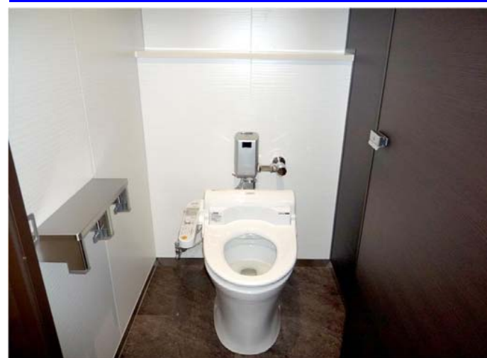
手動式フラッシュバルブを自動洗浄のオートクリーンに取り替えることで、非接触性と節水性を高めている。また、近年要望の高まっている音姫を男性トイレにも設置。
