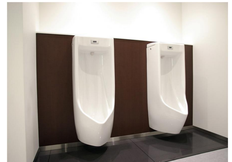
大便器同様自動洗浄対応の器具を選定し節水性を確保すると共に奥行きのあるライニングを採用し、手荷物に配慮した。
