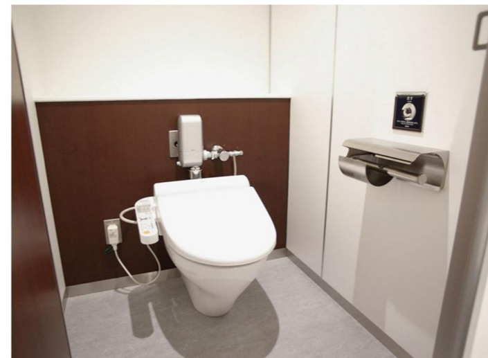
小物も置ける奥行きのある大便器ライニングを採用。自動フラッシュバルブを選定し節水性に配慮している。
