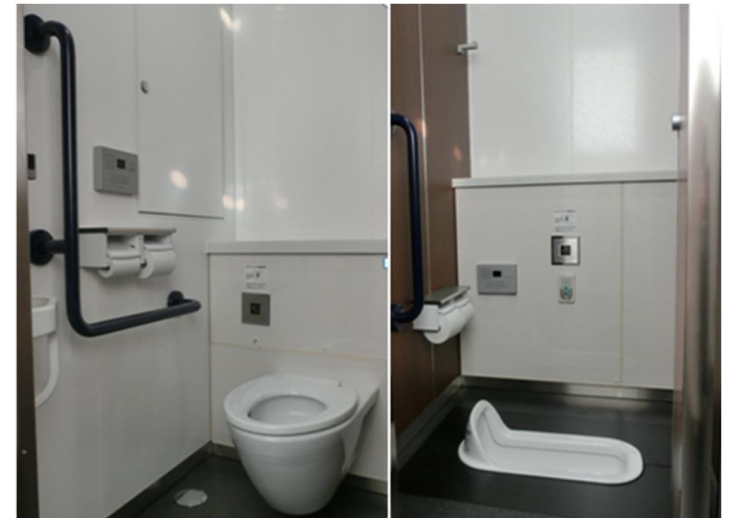
床の清掃性に優れた壁掛式大便器と洗浄はセンサースイッチ、音姫(擬音装置)を採用。男女トイレ共に、1ヶ所ずつ和式便器を設置して便器まわりの床にはにおいや汚れを軽減するハイドロセラ・フロアを設置している。
